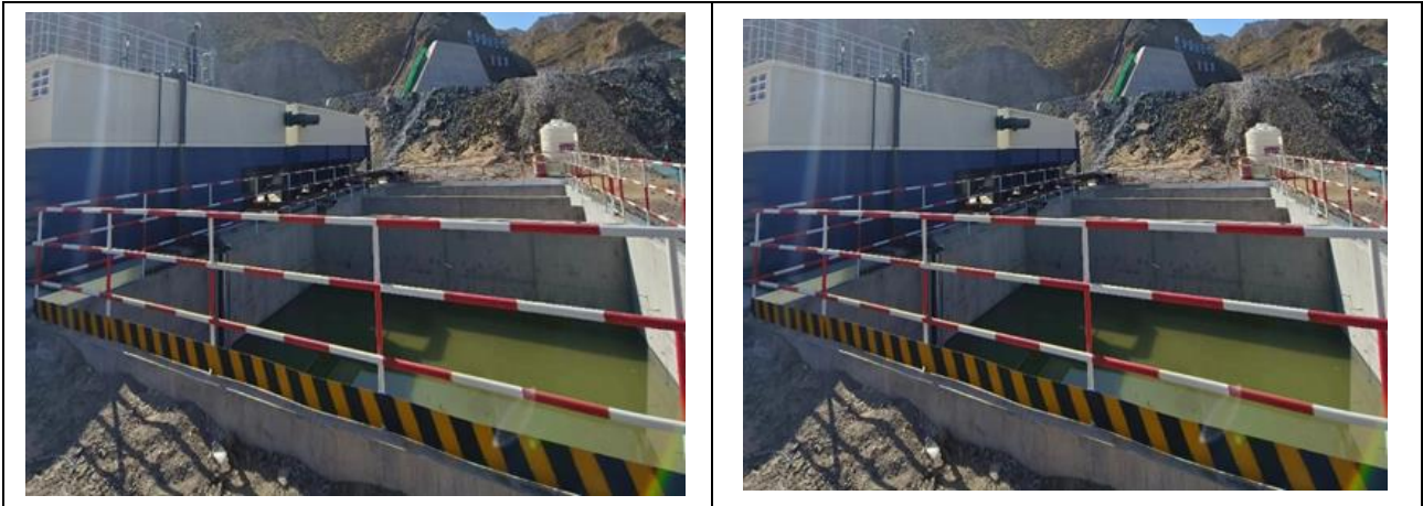
图 4.1-9 水电七局洞室废水一体化废水处理系统
