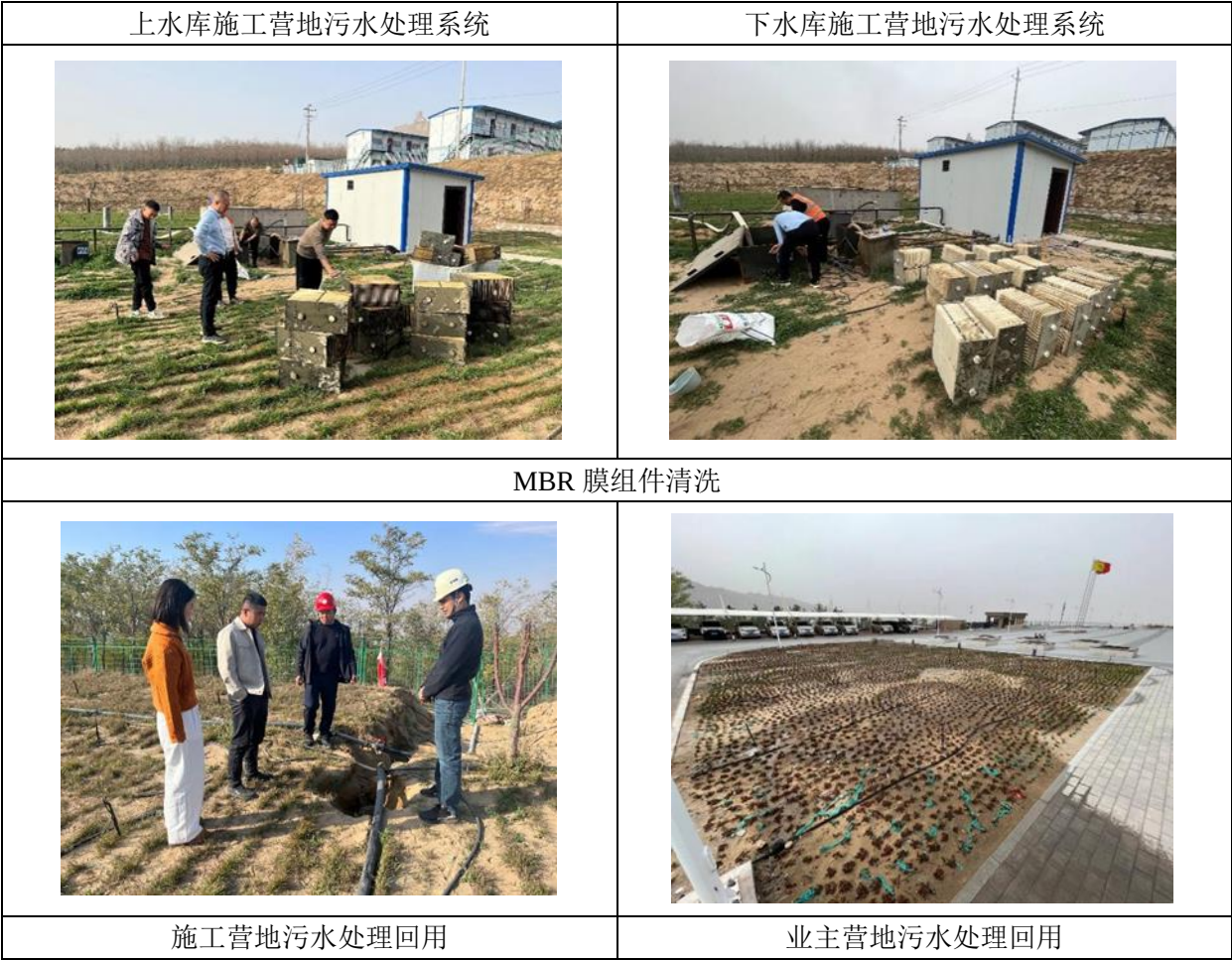
图 4.1-13 生活污水处理设施
