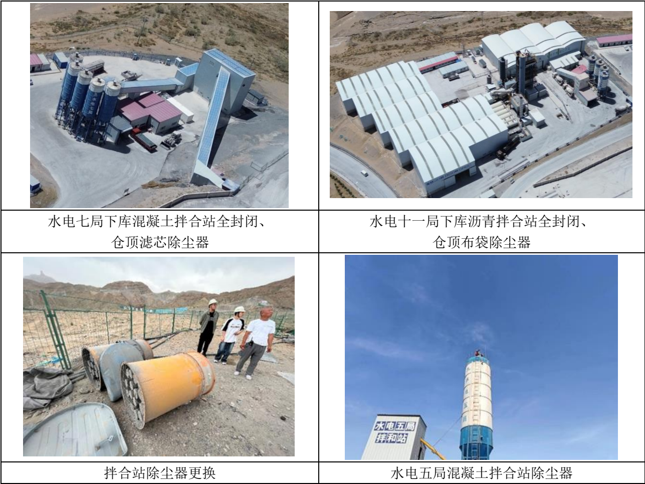
图 4.3-6 混凝土生产系统除尘措施
