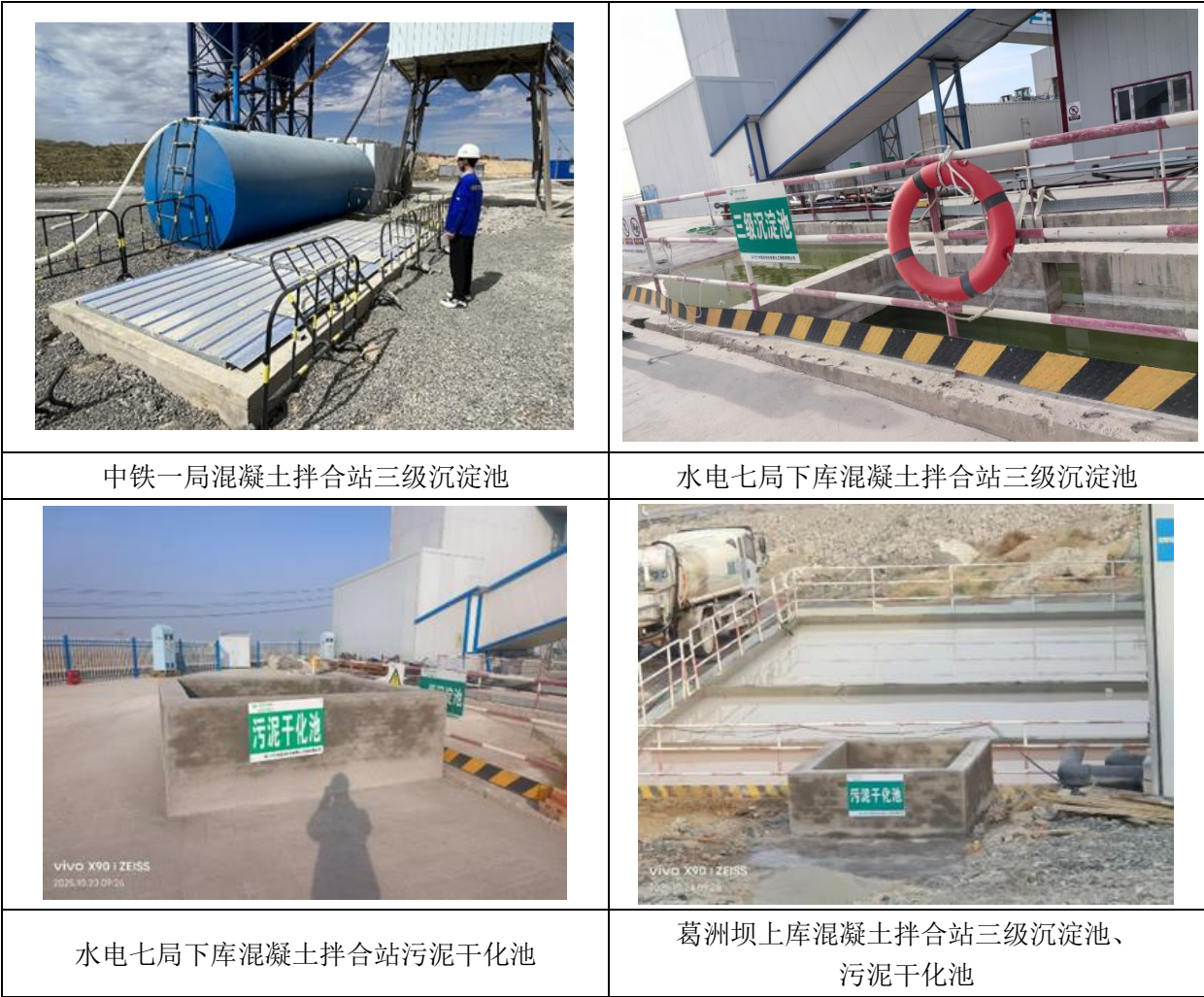
图 4.1-3 各标段混凝土系统废水沉淀处理设施
