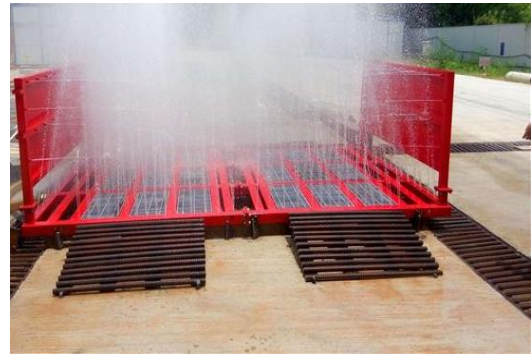
车辆冲洗废水沉淀池
