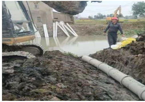
基坑废水沉淀池
